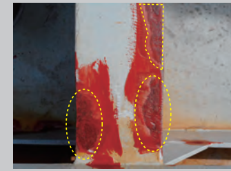
(ケレン部が隠蔽していない)
